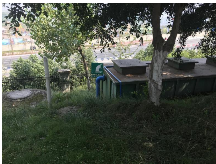
2#污水处理设施
